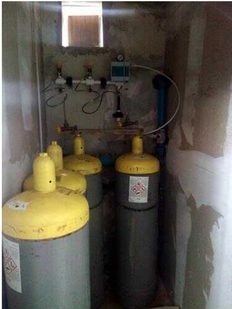
Slika 5.1 – Spremnici klora unutar klorne stanice
